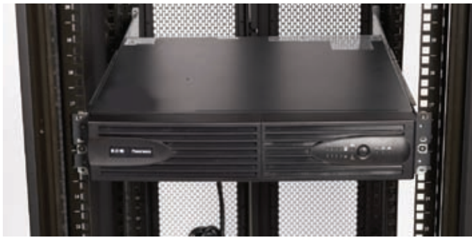
Installation en baie d'un onduleur 2U
