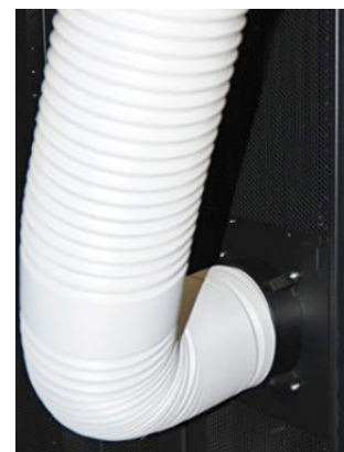
Extraction d'air chaud
